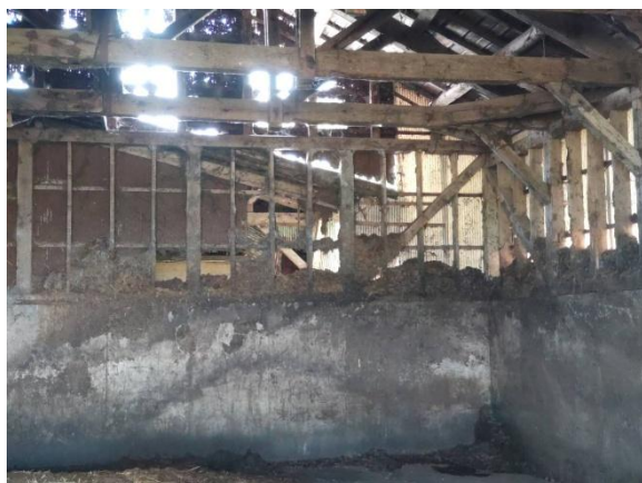
補修前 堆肥舎 壁
