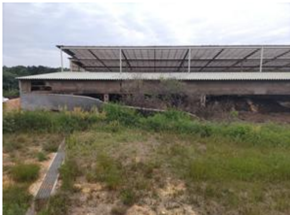
補修前 堆肥舎 壁
